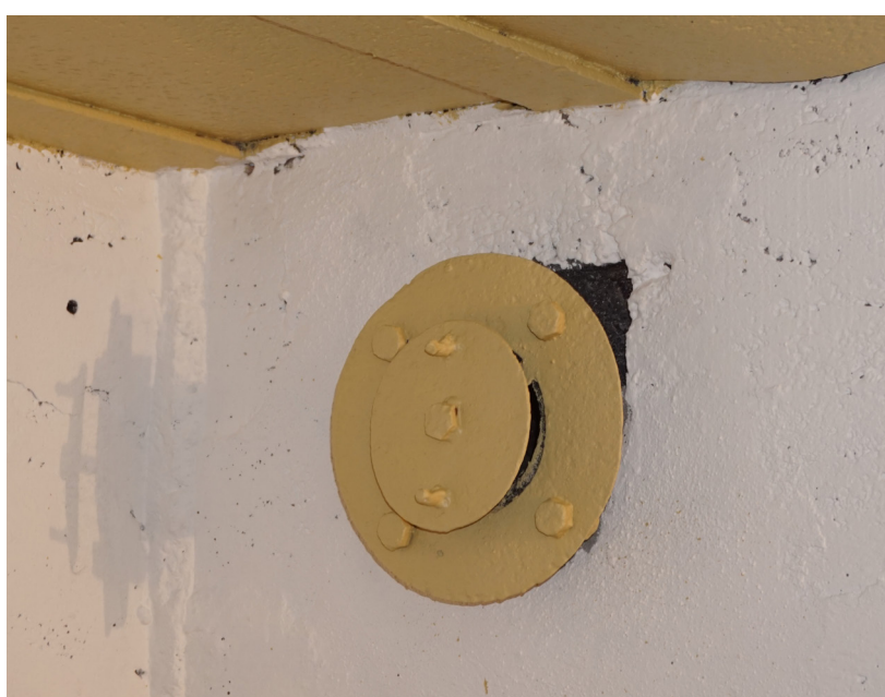
Bouche de ventilation du local à munitions
